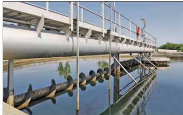
Filtern, Waschen und Trennen von verschiedenen Komponenten bereiten das Abwasser für die Mikroorganismen auf.
