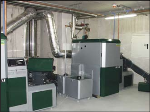
Ob für Wohnhausanlagen oder Ortsteile: Ein langfristiger Liefervertrag für Heizwärme aus Biomasse rechnet sich.
