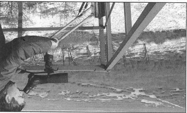
Hans Fleischhacker, Hausstechniker im Informationszentrum, montierte das Spezialstativ am Sandeck-Turm.
